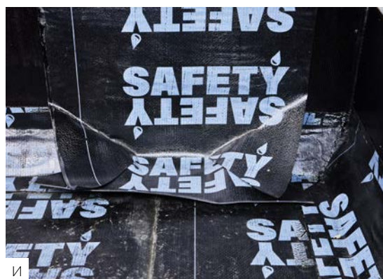
И Наплавьте Safety EPP на вертикаль так, чтобы край материала приходился на ось воронки. Подробное описание наплавления на вертикальные поверхности см. п. 6.2.
